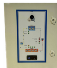
Cuadro Electrico Especial Para Unidad Scroll 12hp
