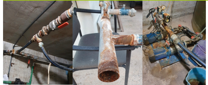
Estado de tuberías de agua en edificio sin mantenimiento
